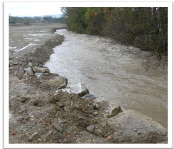
Figure 12 : après travaux, en crue elle se charge d'enlever elle-même les matériaux et se crée son nouveau gabarit © SMMAR
