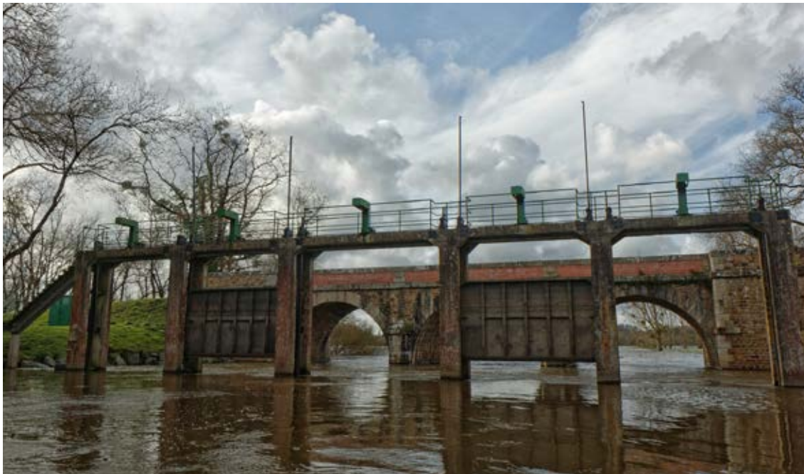
Le vannage de Bouaye à la « sortie » du lac vers l'Acheneau, ici en écoulement (deux vannes totalement ouvertes).
