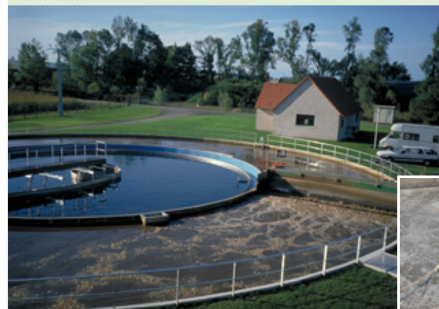
Vue d'une station d'épuration à boues activées. Des capteurs sont placés à la surface des bassins pour collecter et mesurer en ligne les émissions de protoxyde d'azote issues de la biodégradation des eaux usées.
