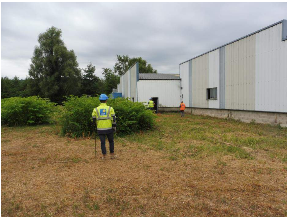
27/06 Implantation de la butte paysagère destinée à permettre le stockage in situ des terres impactées
