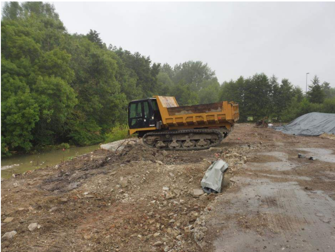
La dalle béton qui recouvre l'îlot a été partiellement éliminée pour permettre les terrassements
