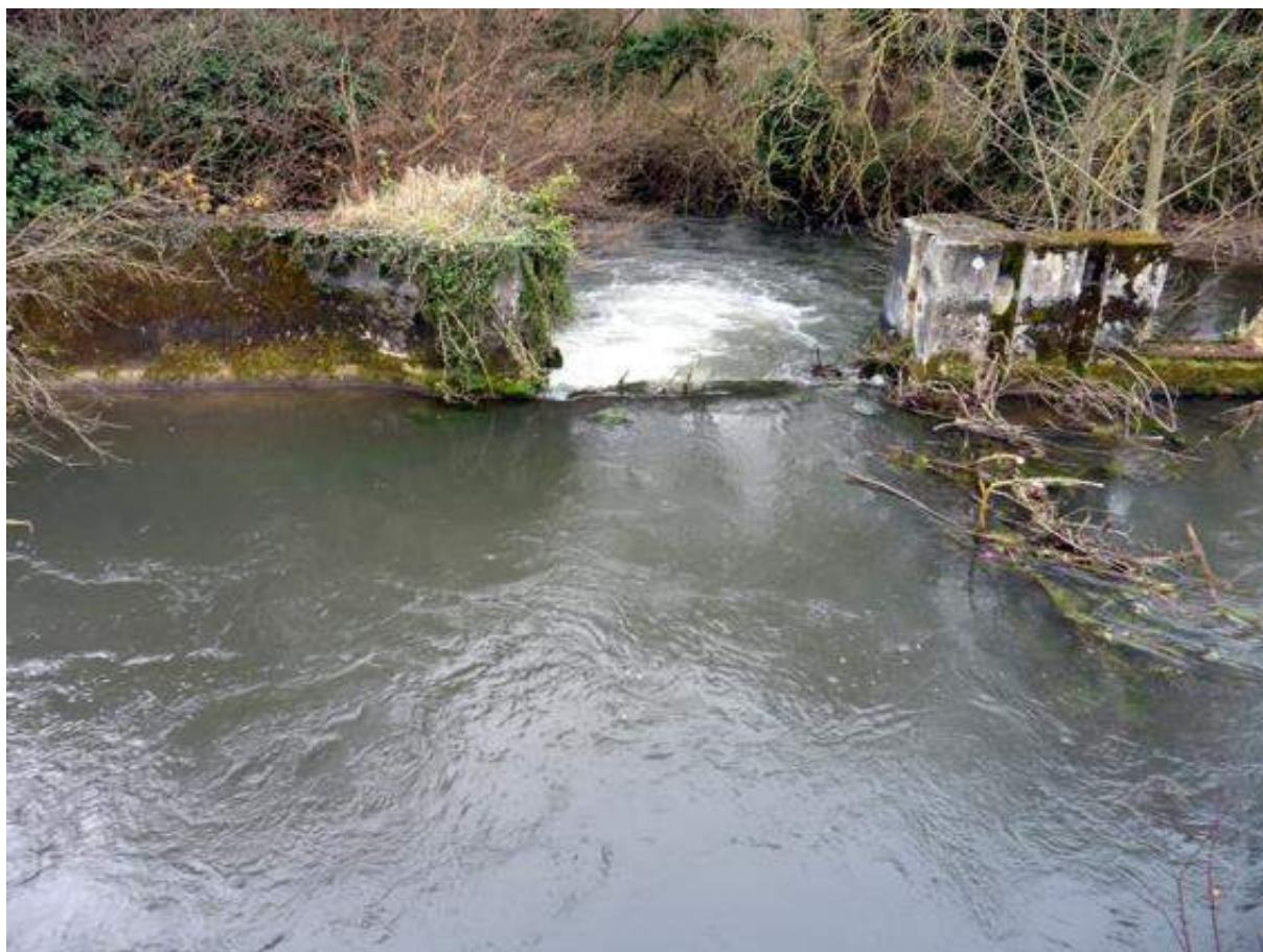
La chute de l'ouvrage (décharge du moulin)
