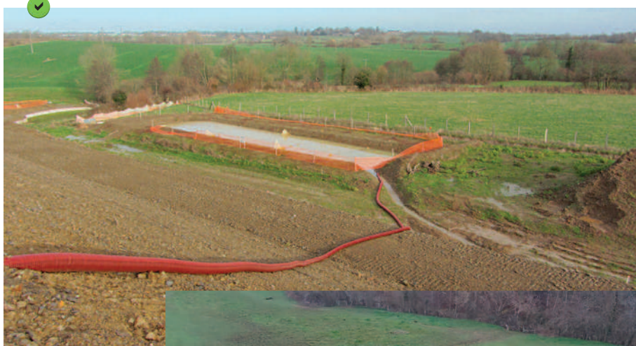
Drain de pente.
