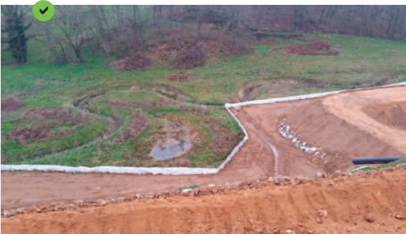
Barrière de rétention longeant un cours d'eau.
