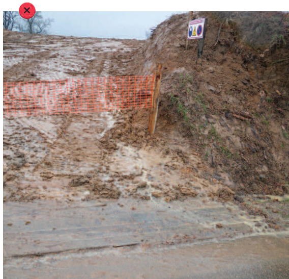
Accès au chantier non aménagé.
