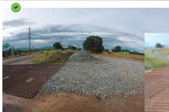
Fosse drainante et grille métallique ondulée.
