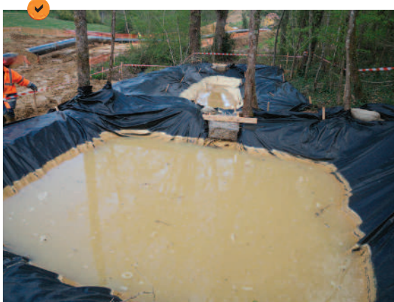
Dispositif de surverse à gabion de paille.
