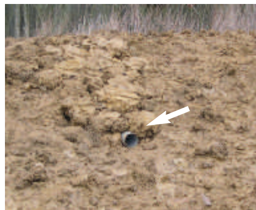
Tuyau de trop plein.
