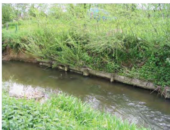
Photo 3 : Tunage et lit de saules sur le Traubach à Traubach-le-haut (LE BRETON, 2004).
