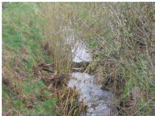
Photo 4 : Seuil ne fonctionnant pas sur l'Aroffe à Tramont-Emy (LE BRETON, 2004).
