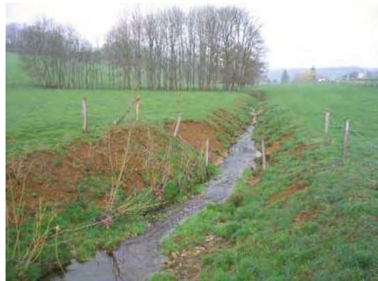
Photo 7 : Berge retalutée avec pose de géotextile sur l'Aroffe à Tramont-Emy (LE BRETON, 2004).
