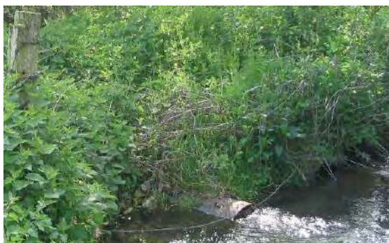
Photo 2 : Passage busé sur la Dieue à Dieue sur Meuse (LE BRETON, 2004).
