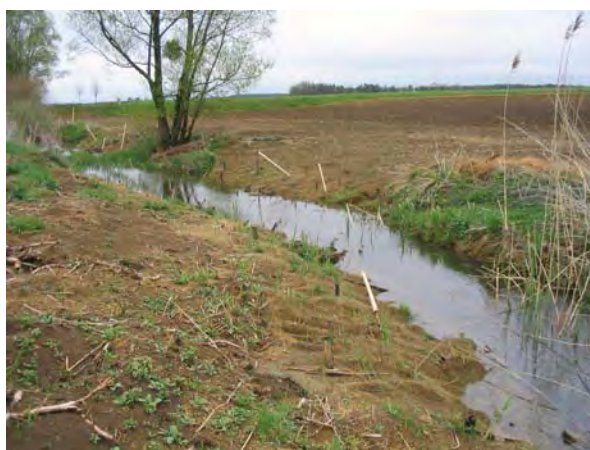
Figure 27 : Travaux en cours sur le Moutru à Saint Hilaire en Woëvre (LE BRETON, 2004).
