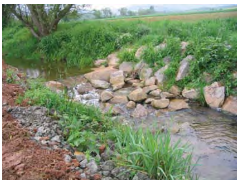
Figure 20 : Seuil en enrochement sur la Schernetz à Epfig (LE BRETON, 2004).
