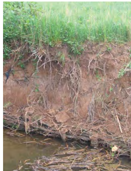
Figure 33 : Protection de berges par rapport à la recréation de berges sur la Schernetz à Epfig (LE BRETON, 2004).
